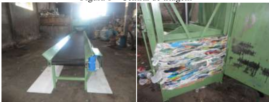
Figura 1 – Central de triagem
