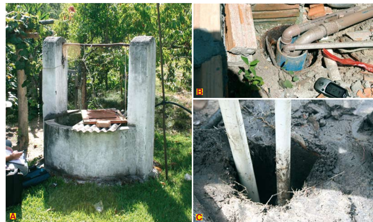
Fig. 25: Exemplos de poços construídos fora dos padrões e que podem provocar alterações na qualidade da água subterrânea. (A) poço cacimba, não regulamentado pela legislação; (B) aberto, sem laje sanitária; (C) aberto, sem revestimento e sem laje sanitária
