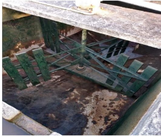
Figura 3 – Floculador mecanizado de eixo vertical
